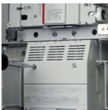
CUBIERTA AISLANTE INTERRUPTOR PRINCIPAL
